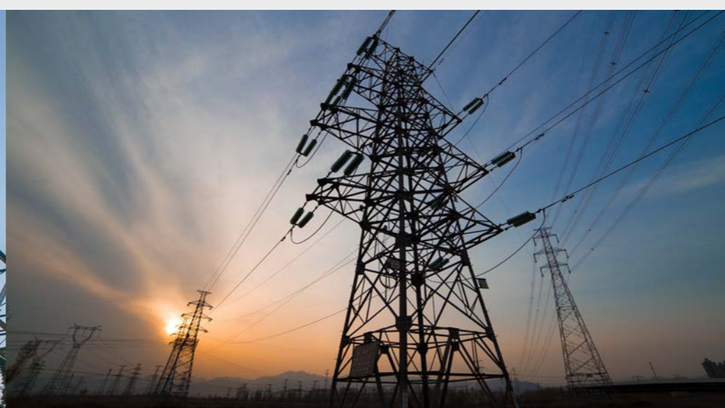
➔ Torres de alta tensión
